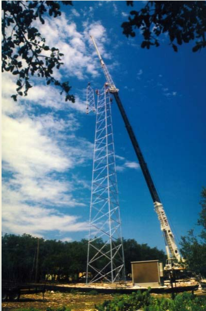
Supervisión de Maniobras
